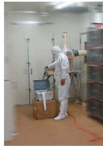
・クリーンルームの気密測定 (超小口径風道+高圧ファン)
